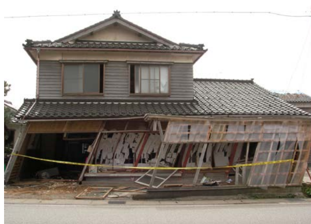
写真2 木造住宅の被害例(壁が少ない建物)
