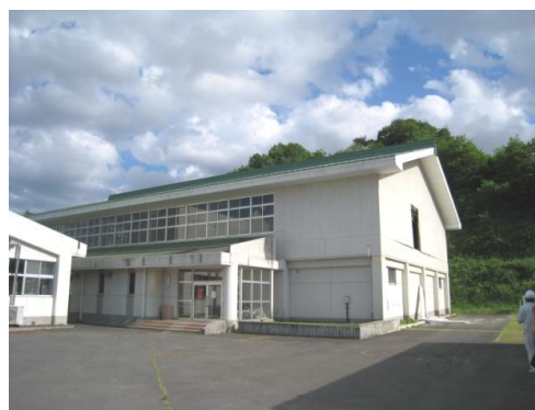
写真 14 宝来小屋内運動場の全景 (妻壁の ALC 版が脱落し落下)
