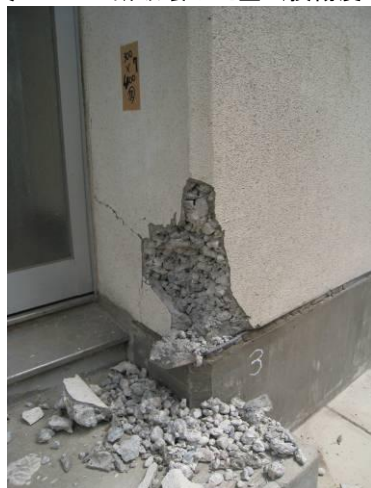
写真10 曲げ圧壊した柱脚（ジャンカが見られる）
