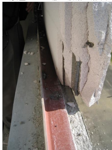
写真 15 ALC 版接合部 (鉄筋溶接部が外れる)
