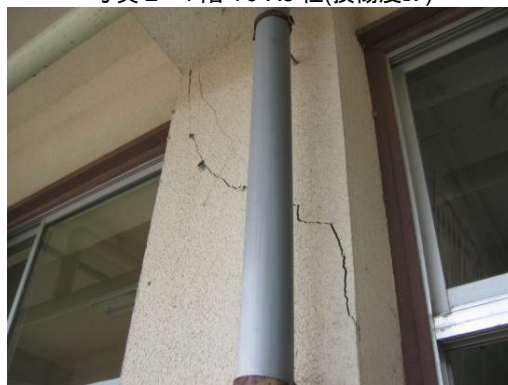
写真3 1階 Y0-X8 柱(損傷度Ⅲ)
