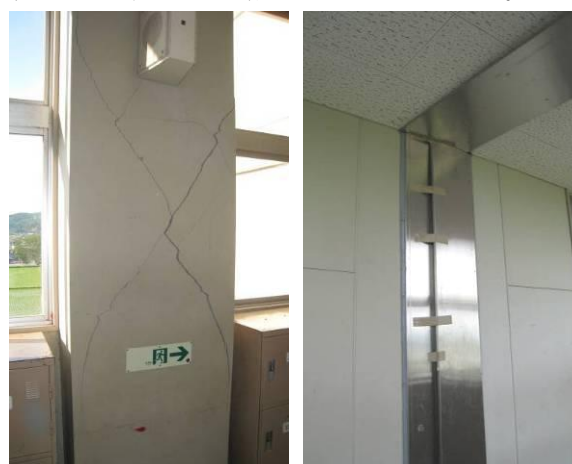
写真7 (左) 柱のせん断ひび割れ (損傷度Ⅲ)
