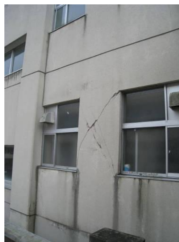
写真11 非構造壁のせん断ひび割れ（損傷度III）
