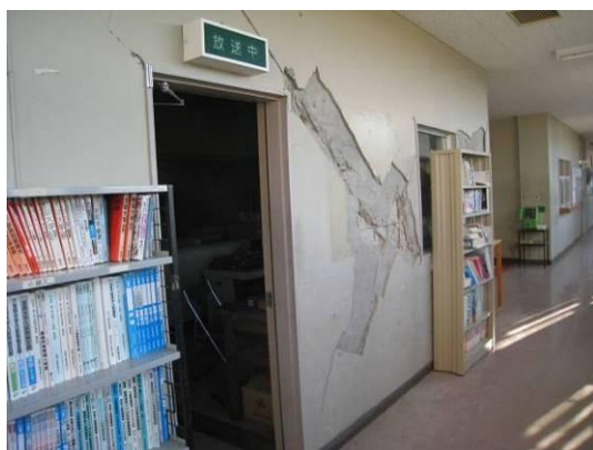
写真9 せん断破壊した壁（損傷度IV）
