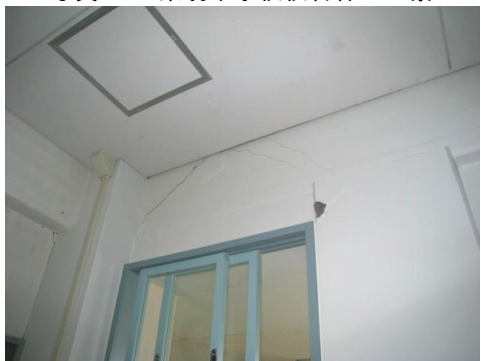
写真 13 補強壁開口上部の梁のせん断ひび割れ
