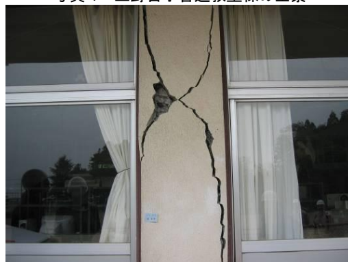
写真2 1階 Y0-X6 柱(損傷度Ⅳ)
