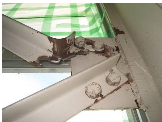
写真5 接合部におけるブレースの破断
