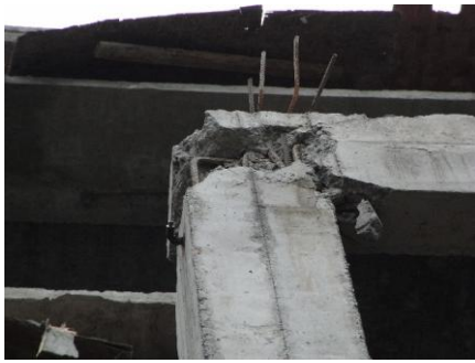
写真9 柱梁接合部のせん断破壊
