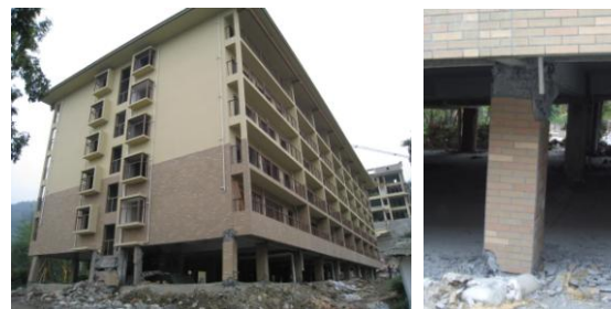
写真11 例題建物全景と1階柱の残留変形
