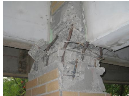
写真7 1階側柱柱頭の曲げ圧壊
