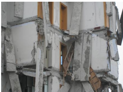
写真4 RC臥梁とPCa中空床スラブの崩落
