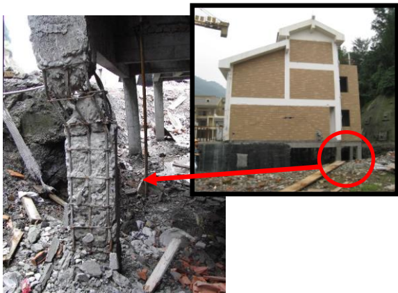
写真10 地盤変状による柱の損傷
