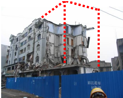
写真3 建物両妻側スパンの部分崩壊
