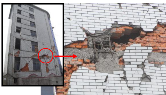
写真5 レンガ壁とRC間柱のせん断破壊
