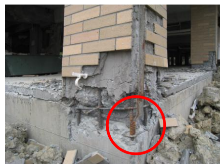
写真8 1階隅柱脚部主筋の破断
