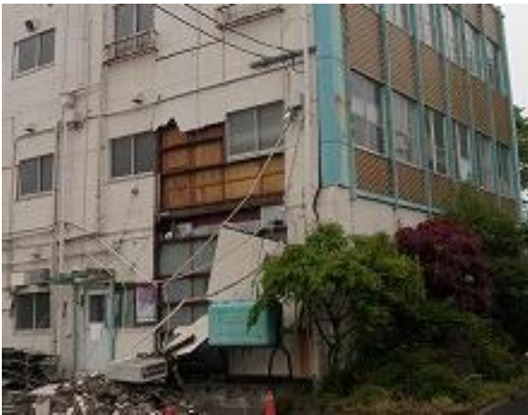
図-8 ラスシートモルタル仕上被害
