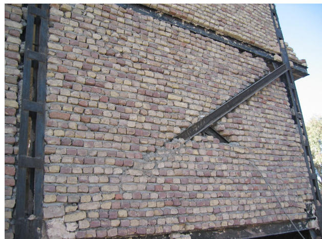
写真11 座屈しレンガ壁から孕み出した鉄骨ブレース
