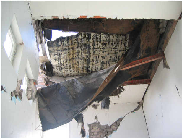
写真 5 ペントハウスの屋根の落下
