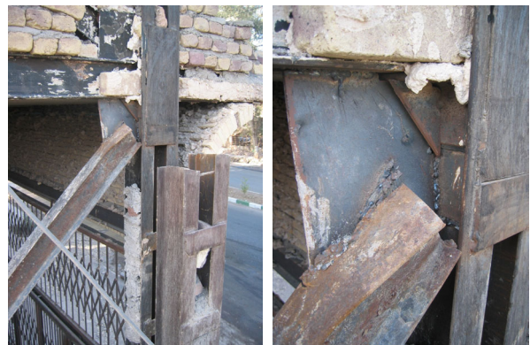
写真9 溶接が破断した ブレース端部
