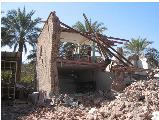
写真 7 倒壊した 2 階建の学校校舎
