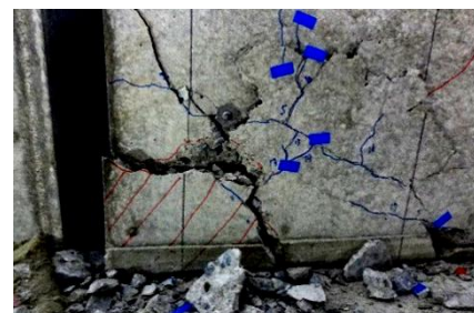
写真1 R=-1/50radにおける袖壁端部の損傷状態
