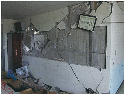
写真-1 せん断破壊したRC壁
