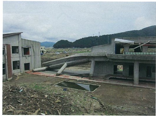
写真-8 津波で倒壊した渡り廊下
