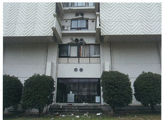
写真-3 せん断破壊した有孔梁
