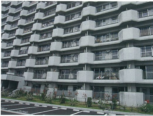
写真-5 高層集合住宅の方立て壁のせん断破壊
