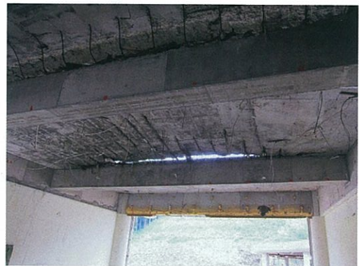
写真-9 津波で上方に湾曲し破壊した床スラブ
