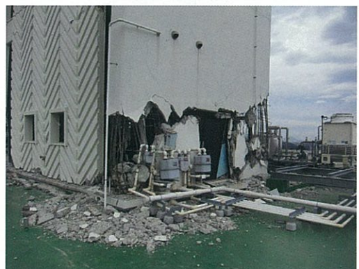
写真-4 大破したペントハウス
