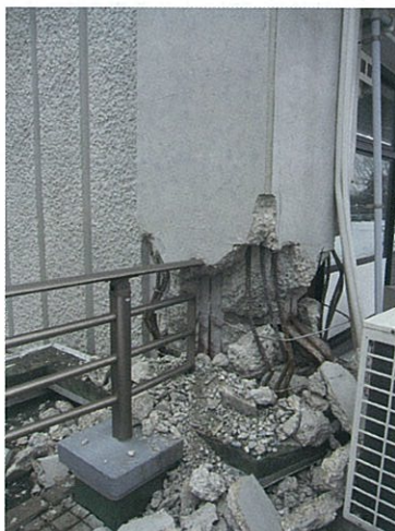
写真-2 圧縮破壊した柱
