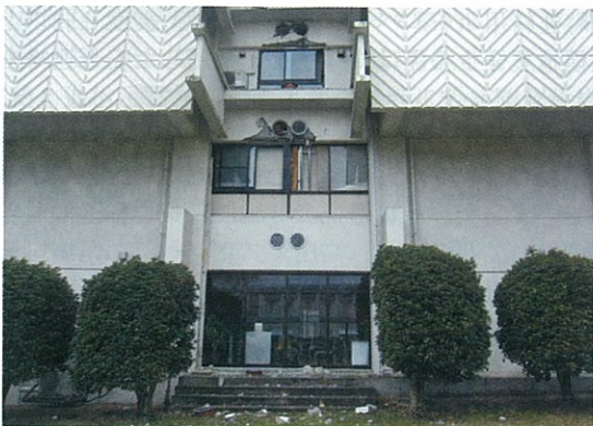
写真6 東側の壁をつなぐ梁のせん断破壊
