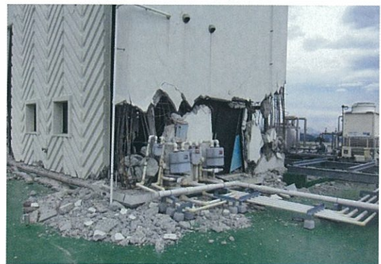
写真8 ペントハウスのRC壁の破壊
