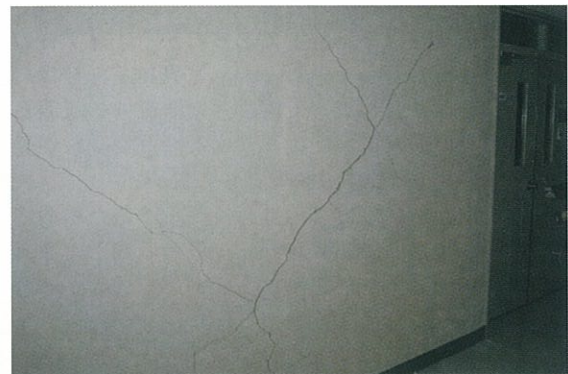
写真12 壁のせん断ひび割れ
