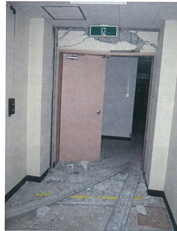
写真7 建物内の中廊下部の梁のせん断破壊
