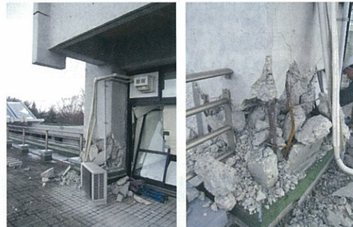
写真3 3階の耐震壁側柱の破壊状況
