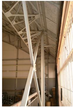
写真 13 座屈した桁ブレースの破断
