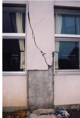
写真 18 南側構面の柱のせん断ひび割れ (校舎①-1)
