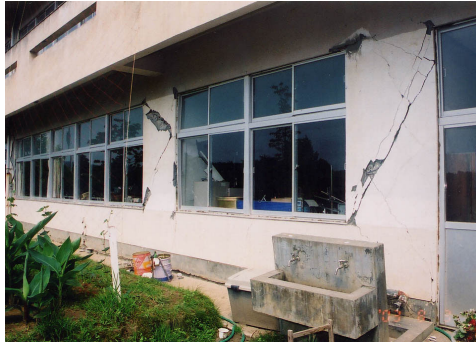
写真2 南構面の柱の被害状況
