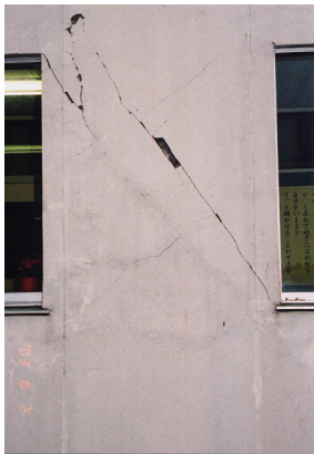
写真 17 北側構面の非構造壁のせん断ひび割れ (校舎①-1)
