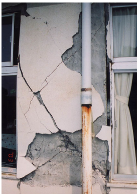
写真3 せん断破壊した柱
