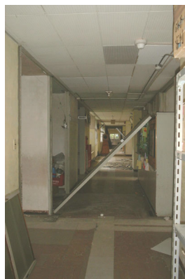
写真5 転倒した防火扉
