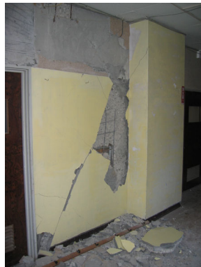
写真4 袖壁付柱の損傷
