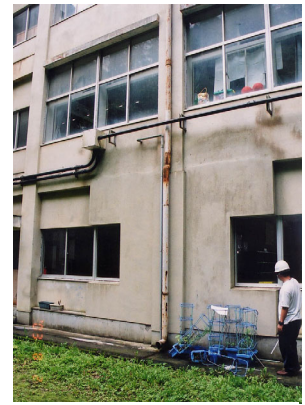
写真 16 柱にRC巻補強し袖壁及び腰壁・垂れ壁を補強（北構面）
