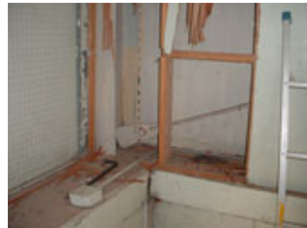
写真6 ブレース接合部の破断
