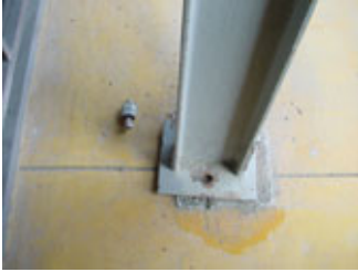
写真 12 間柱柱脚のアンカーボルトの破断
