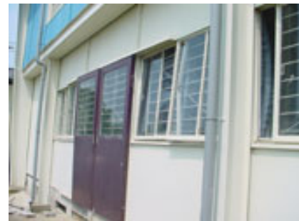
写真7 開口部・窓ガラスの損傷
