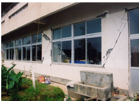
写真-1 南構面の柱の被害状況
