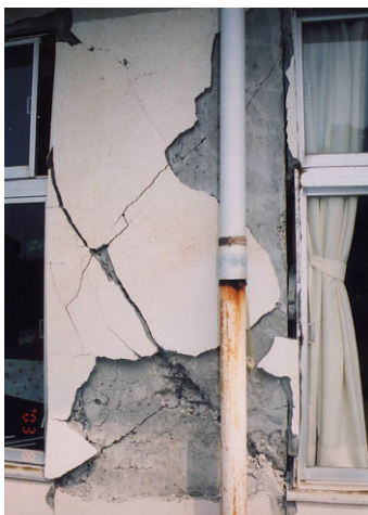
写真-2 せん断破壊した柱(A通り⑤柱)
