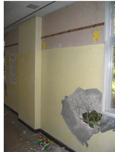
写真-3 袖壁の損傷(C通り④柱)
