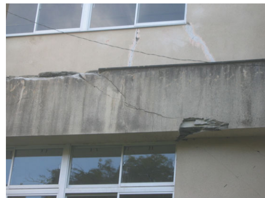
写真-4 袖壁付柱に接続する梁の損傷
