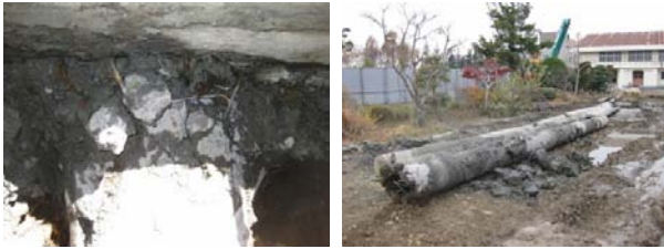
写真3-4 A19杭頭の破損と打込施工時の杭先端破損
