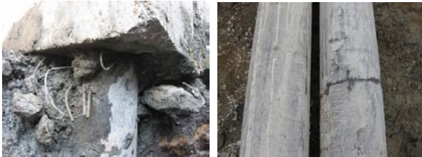
写真3-2 A9杭頭破損と杭先端+14790mm位置の曲げひび割れ
