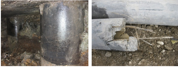
写真3-1 D4杭頭ひび割れと杭先端+15550~16150mm (杭頭から2800~3400mm)の位置の破損
