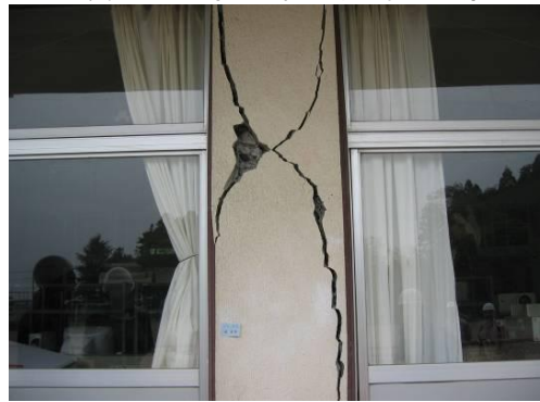
写真 13 1階 Y0-X6 柱(損傷度Ⅳ)
