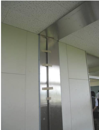
写真 22 EXP. Joint カバーの損傷
