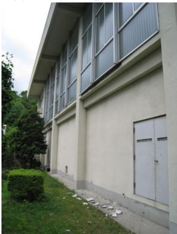
写真 8 屋内運動場の窓枠が変形し、仕上げモルタルが剥落
