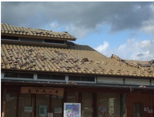
写真1 木造店舗の屋根瓦の被害
