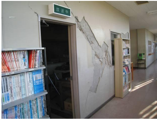
写真 20 せん断破壊した壁（損傷度Ⅳ）
