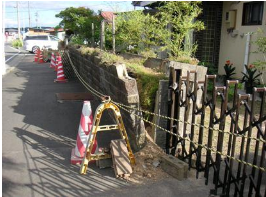
写真2 ブロック塀が損傷し大きく傾斜
