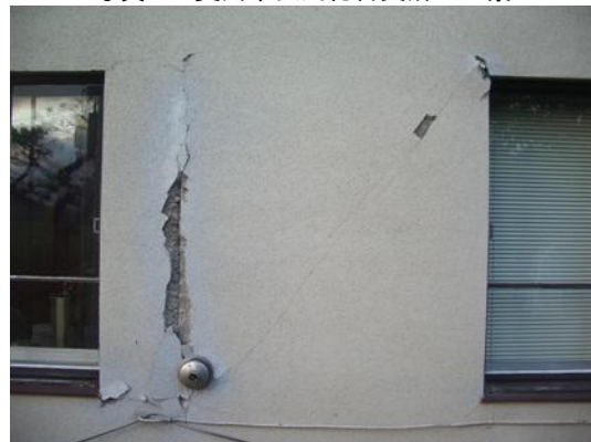
写真 10 非構造壁に生じた損傷
