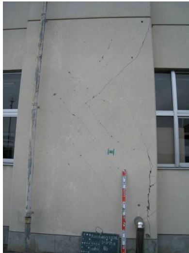
写真 21 壁のせん断ひび割れ（損傷度Ⅲ）
