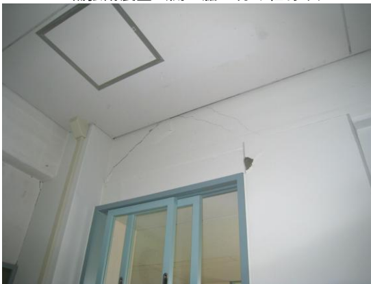
写真 26 補強壁の開口上部の梁のせん断ひび割れ
