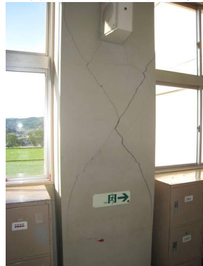
写真 19 柱のせん断ひび割れ（損傷度Ⅲ）
