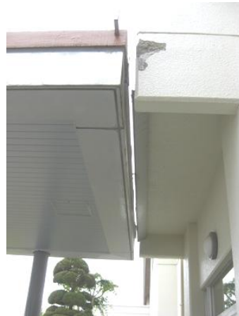
写真4 校舎と渡り廊下の Exp. J の損傷
