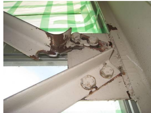
写真 17 接合部におけるブレースの破断
