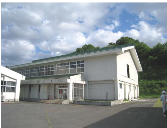
写真 27 宝来小屋内運動場の全景（妻壁の ALC 版が脱落下）
