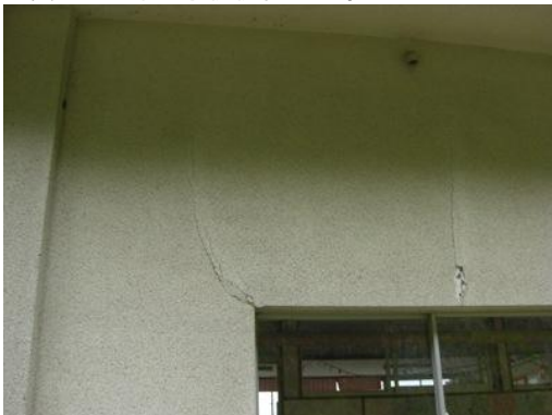
写真 7 校舎の非構造壁のひび割れ
