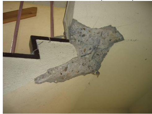
写真 15 階段踊り場部分の損傷
