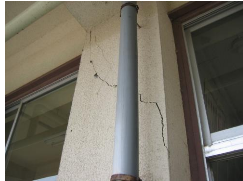
写真 14 1階 Y0-X8 柱(損傷度Ⅲ)
