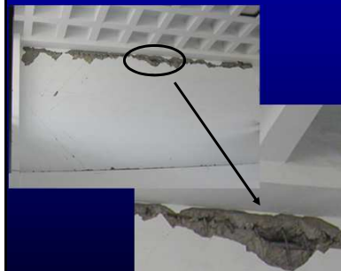
一部縦筋の変形が見られるが、損傷は局所的
