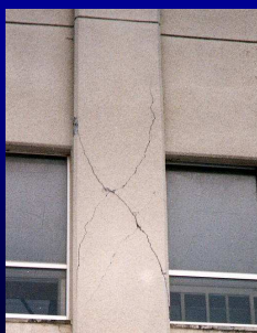
躯体のひび割れ幅は2mm程度
