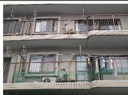
非構造壁損傷部
