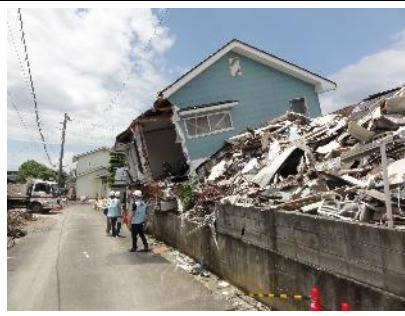
層崩壊した木造住宅
