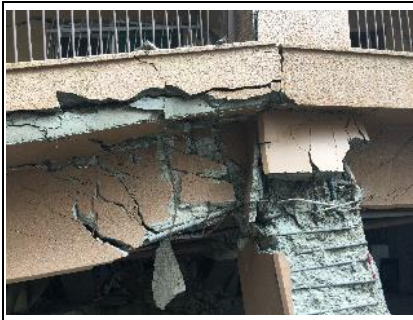
1階柱頭損傷部
