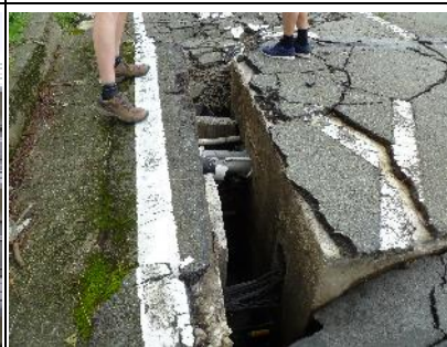
敷地内地面の亀裂
