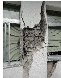
断層直上の柱損傷部
