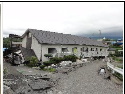
学生アパートの被害
