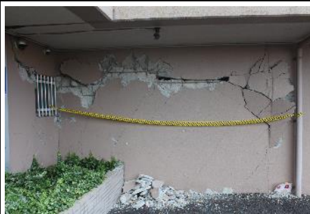
ピロティ耐震壁損傷部
