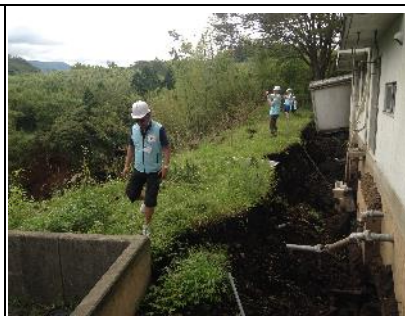
野球部寮裏の崖崩れ
