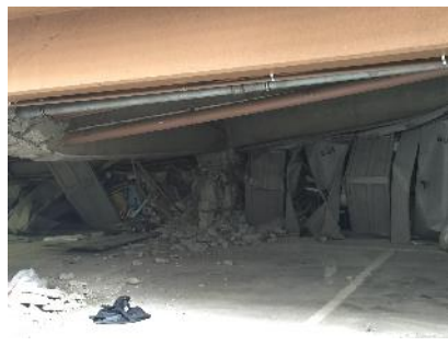
ピロティ崩壊部内部
