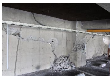
ピロティ耐震壁損傷部
