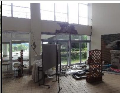
傾斜による梁損傷部
