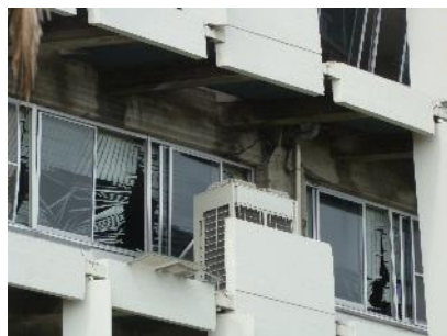
接合部損傷部
