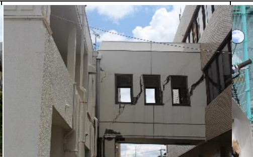
渡り廊下損傷部
