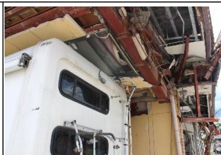
S造建物の層崩壊
