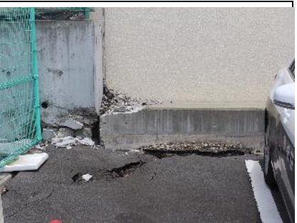
南側基礎コンの浮遊
