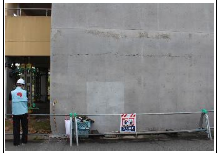
耐震壁損傷部
