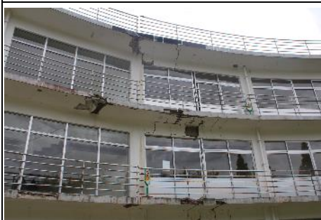
片持ちのスラブの損傷
