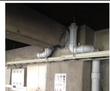
1F 梁損傷部
