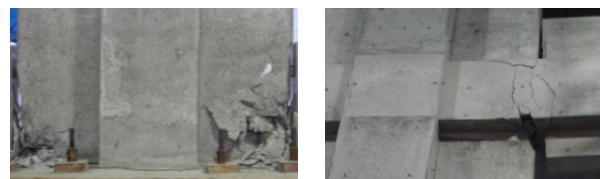
写真1 袖壁付き柱の損傷 写真2 梁の損傷
