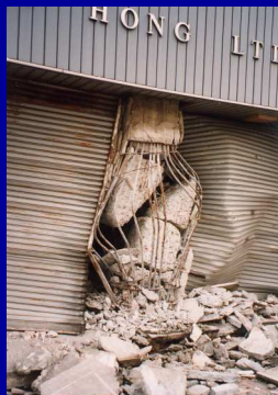
せん断破壊した柱
