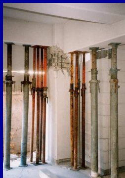
曲げ破壊した柱
