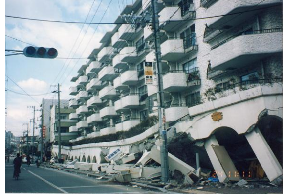
1階が層崩壊した集合住宅
