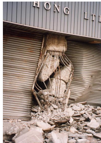
せん断破壊した柱
