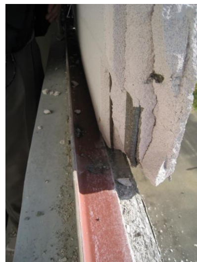
写真 28 ALC 版接合部 (鉄筋溶接部が外れている)
