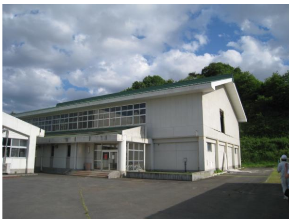
写真 27 宝来小屋内運動場の全景 (妻の ALC 版が脱落し落下)
