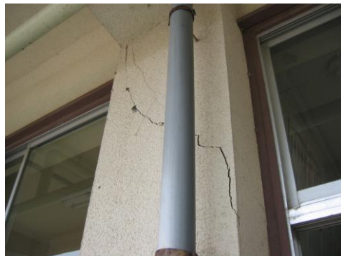
写真14 1階Y0-X8柱(損傷度Ⅲ)
