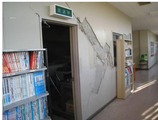
写真 20 せん断破壊した壁 (損傷度Ⅳ)
