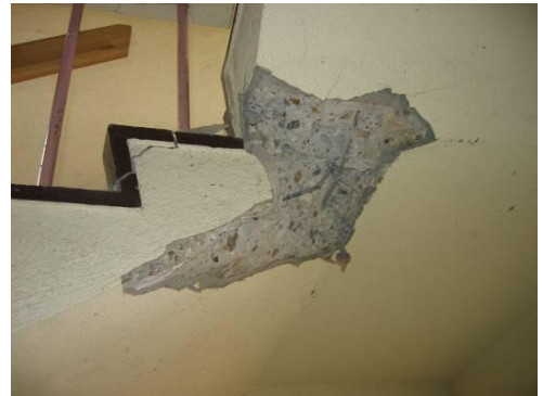
写真15 階段踊り場部分の損傷
