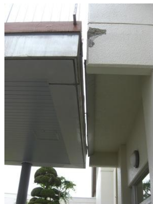
写真4 校舎と渡り廊下のExp.Jの損傷
