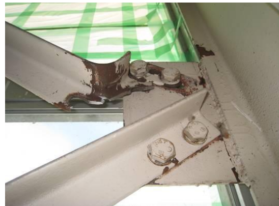
写真 17 接合部におけるブレースの破断
