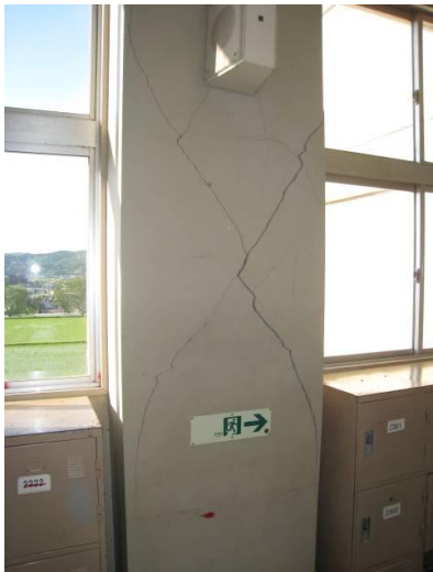
写真 19 柱のせん断ひび割れ (損傷度Ⅲ)
