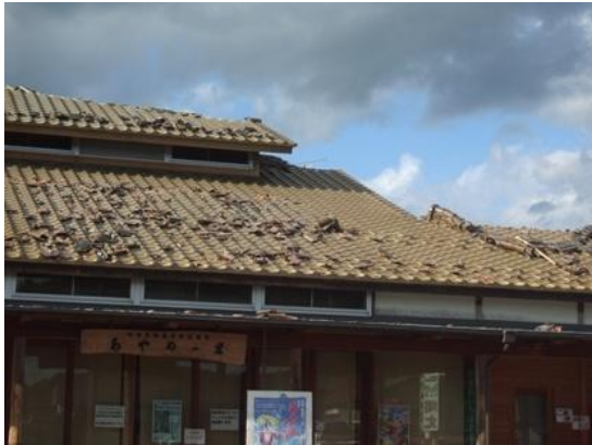
写真1 木造店舗の屋根瓦の被害
