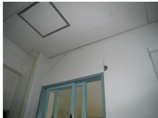
写真 26 補強壁の開口上部の梁のせん断ひび割れ
