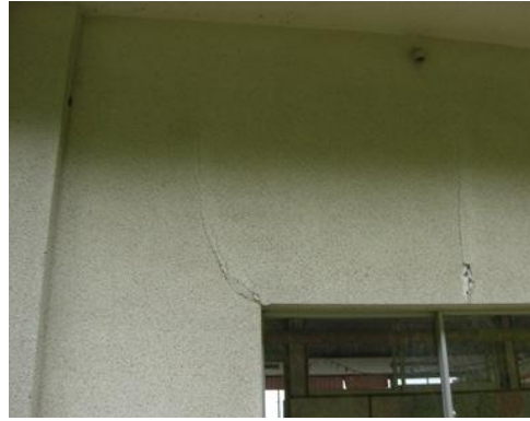
写真 7 校舎の非構造壁のひび割れ
