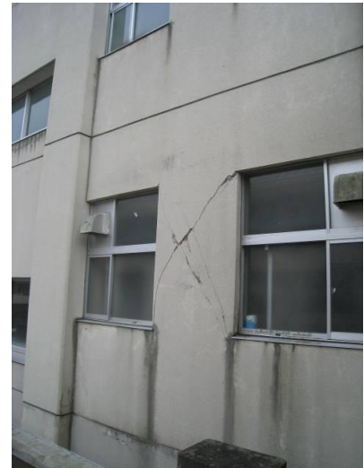
写真 23 非構造壁のせん断ひび割れ (損傷度Ⅲ)
