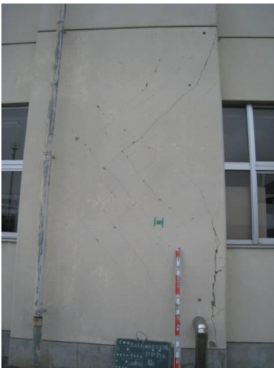
写真 21 壁のせん断ひび割れ (損傷度Ⅲ)
