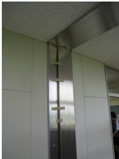
写真 22 EXP. Jointカバーの損傷
