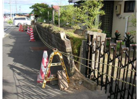
写真2 ブロック塀が損傷し大きく傾斜
