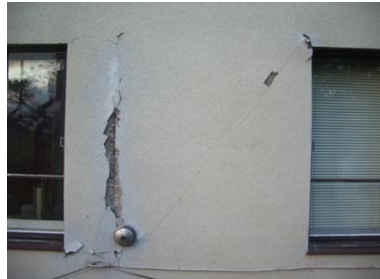
写真 10 非構造壁に生じた損傷
