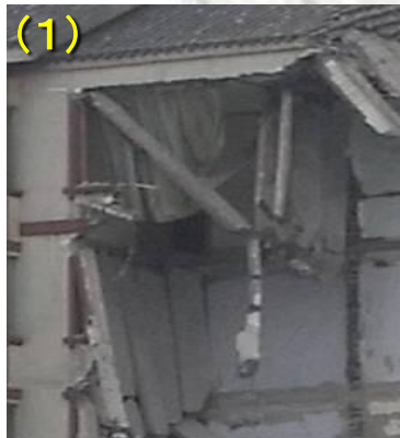
組積造建物の被害
