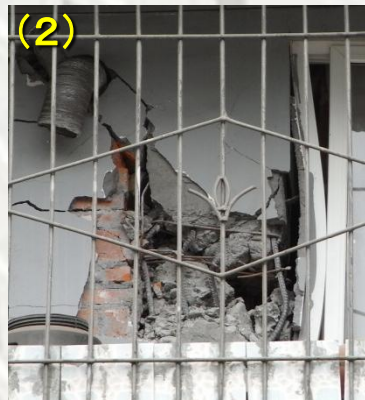
RC造の柱のせん断破壊
