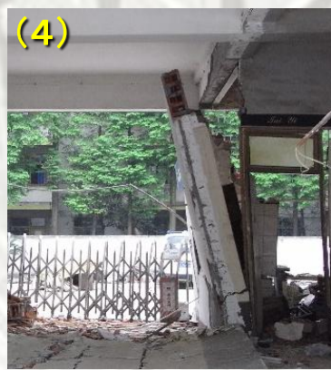
組積造壁の破壊
