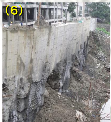
RC造の地盤崩壊に伴う構造被害
