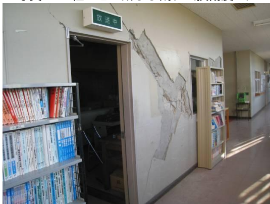
写真 20 せん断破壊した壁（損傷度Ⅳ）
