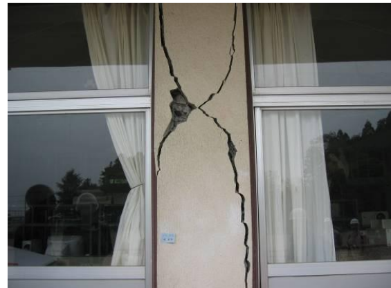
写真13 1階 Y0-X6 柱(損傷度IV)
