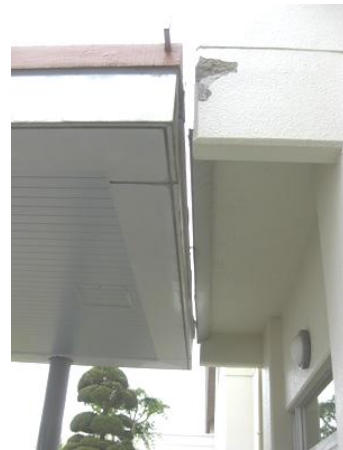
写真 4 校舎と渡り廊下の Exp. J の損傷
