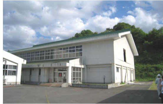
写真 27 宝来小屋内運動場の全景 (妻壁の ALC 版が脱落し落下)
