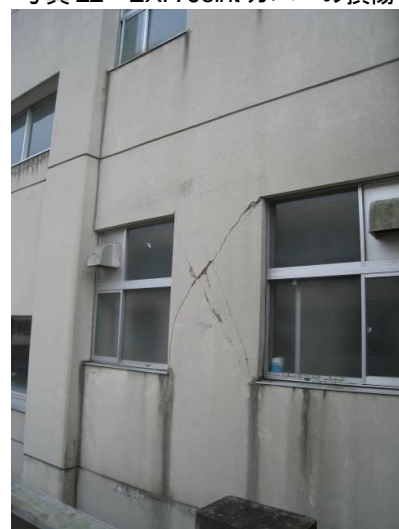
写真 23 非構造壁のせん断ひび割れ（損傷度Ⅲ）
