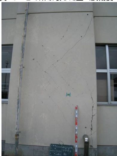
写真 21 壁のせん断ひび割れ（損傷度Ⅲ）
