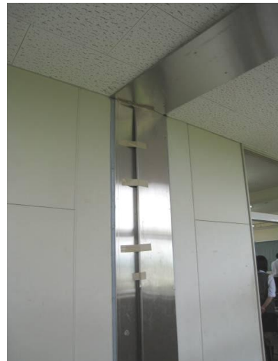
写真 22 EXP. Joint カバーの損傷
