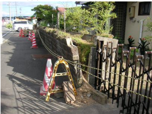
写真 2 ブロック塀が損傷し大きく傾斜
