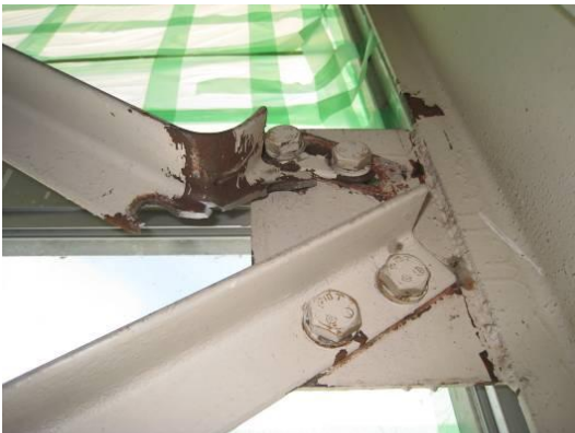
写真 17 接合部におけるブレースの破断
