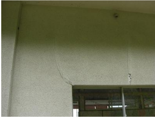
写真7 校舎の非構造壁のひび割れ
