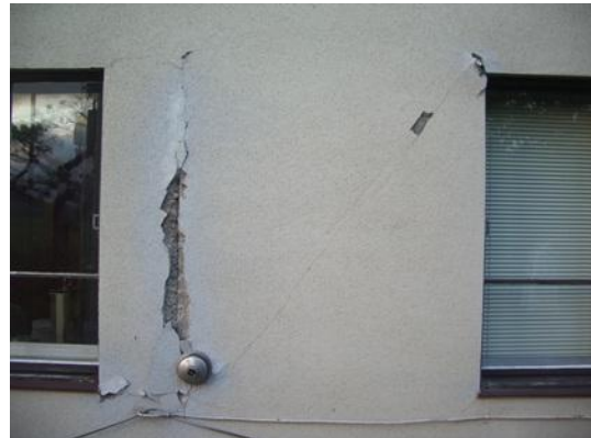
写真10 非構造壁に生じた損傷
