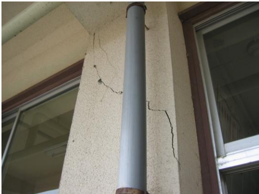
写真14 1階 Y0-X8 柱(損傷度Ⅲ)
