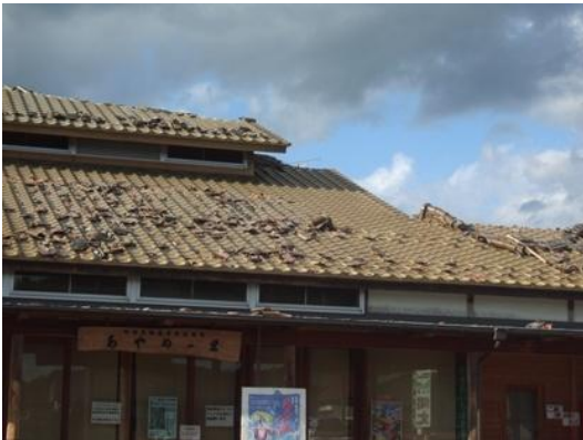
写真 1 木造店舗の屋根瓦の被害
