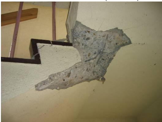
写真15 階段踊り場部分の損傷
