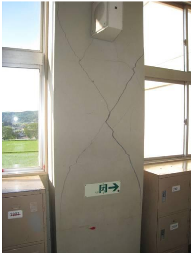
写真 19 柱のせん断ひび割れ（損傷度Ⅲ）
