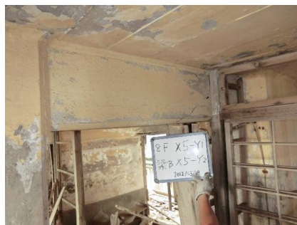
写真1 若干のひび割れ「梁劣化度I」
