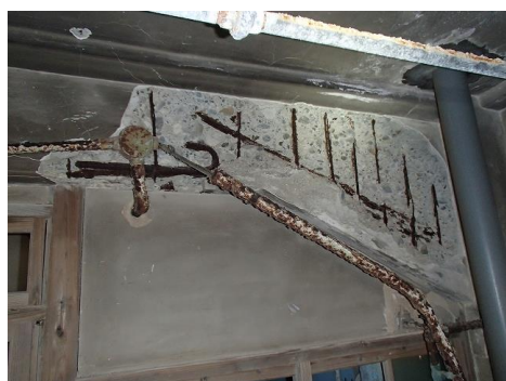
写真5 鉄筋断面がない「梁劣化度Ⅴ」
