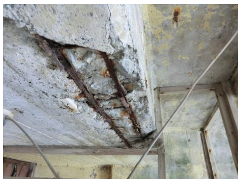
写真4 強度が若干見込める「梁劣化度Ⅳ」
