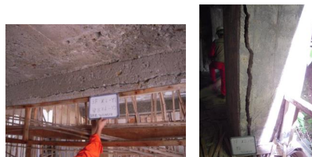
写真3 かぶりほぼ剥落「梁劣化度III」「柱劣化度III片」
