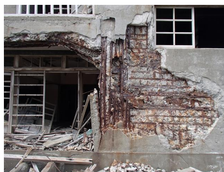
写真6 コア部欠損「柱劣化度Ⅴ」
