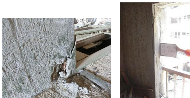
写真2 コンクリートの一部が剥離「柱劣化度II」
